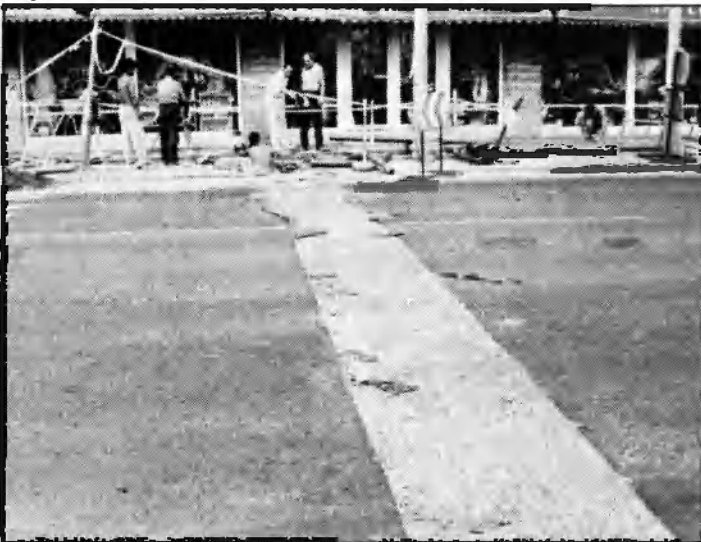
A város több területén találkozhatunk a telefonkábelek feke- tetési munkálataival. A nagyobb közlekedési akadályokat eddig elkerültük, az építők – Somogy Aszfalt – dícséretes gyors- sággal – a hét végén is – dolgoznak.
